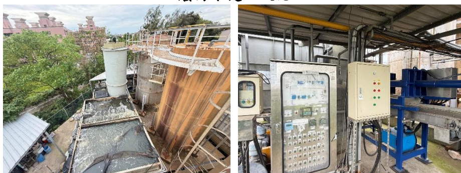
廢污水處理設施
